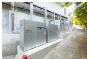
コージェネレーションシステム
